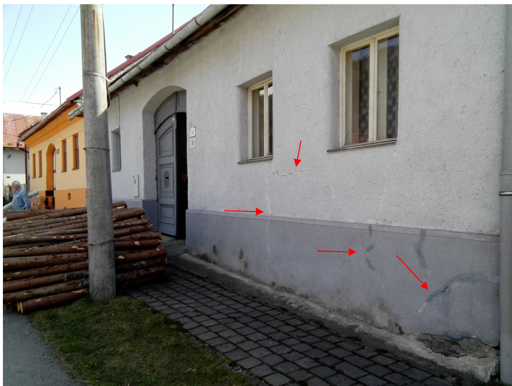
Obr.2: Trhliny v obvodovom murive domu na Debnárskej ulici č.30
