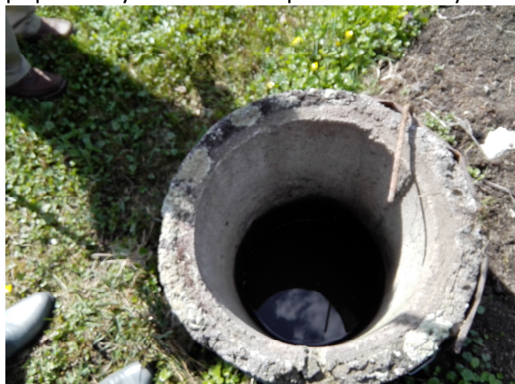
Obr.3: Vysoká hladina podzemnej vody v kontrolných šachtách odvodňovacieho systému a minimálny pohyb vody v systéme
